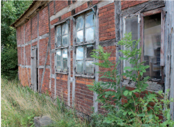
Einsturzgefährdetes Nebengebäude vorher
